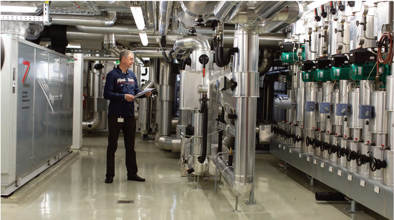
Die Geothermieanlage versorgt das Wiesbadener R+V-Bürogebäude mit Wärme und Kälte.
